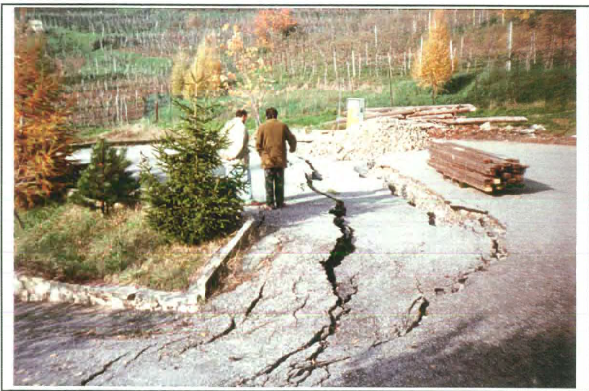
Foto 16. Particolare della precedente ma antecedente (1991), sono visibili le fratture che hanno lesionato il piazzale.
