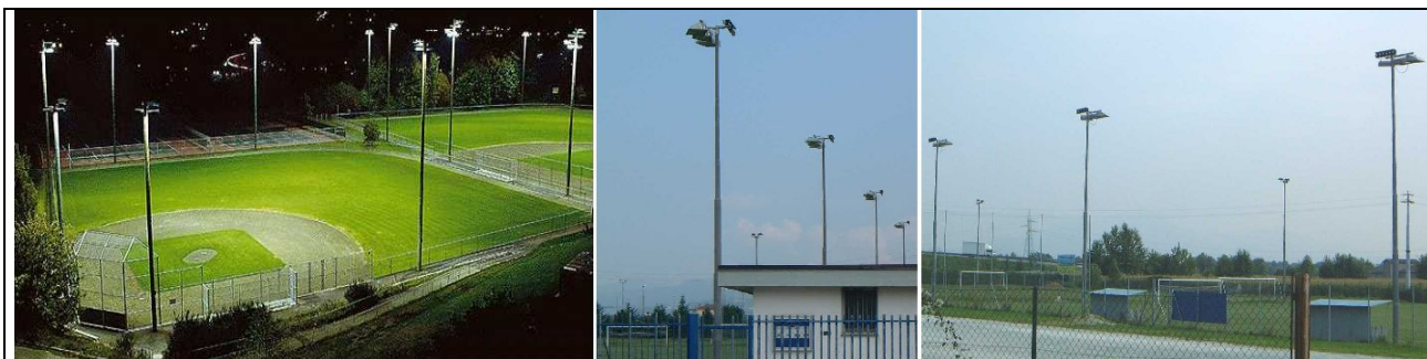
Figura 2.13 - Impianti sportivi illuminati in modo conforme alla L.R. 17/00 con proiettori asimmetrici orientati orizzontalmente e che non disperdono luce verso l'alto.
